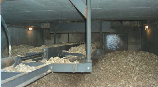
Abb. Heizkessel und Holzheizungsunker
