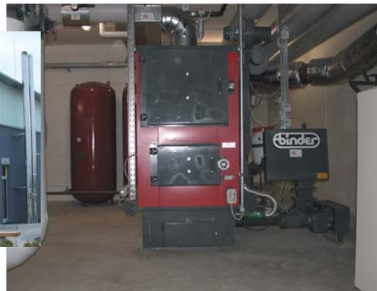
Die Heizzentrale - innen
